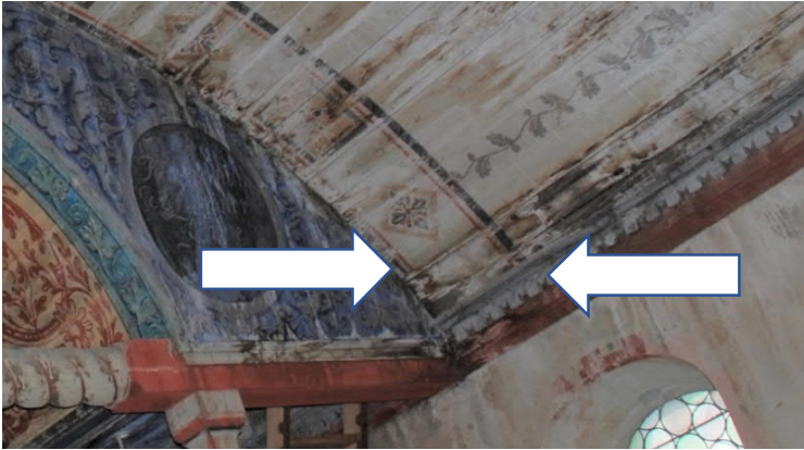
Abbildung 2: Schäden an der Tonnendecke
